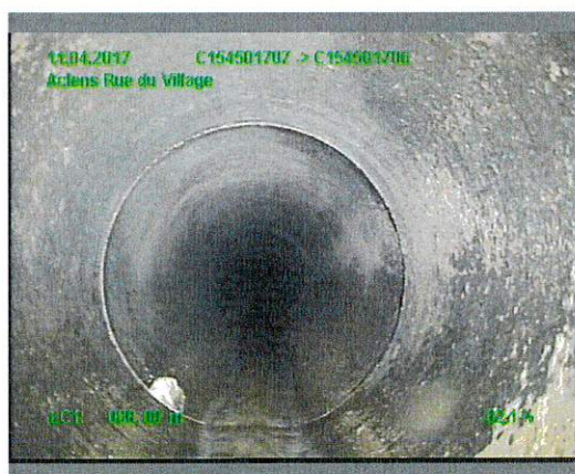
Figure 1: Dégradation du revêtement du collecteur EU
