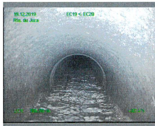
Figure 2: Important dépôts de calcaire dans le collecteur EC
